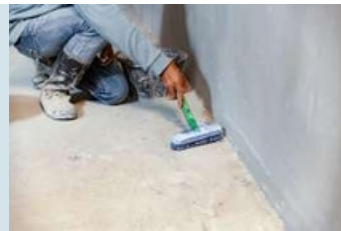
Yüzeyde kırık, bozuk bölgeler onarılmalı
